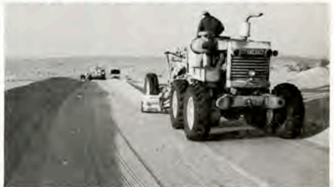
Supply Road är ofta illa utsatt för den "vandrande sanden". Pollog får göra ständiga uttryckningar för att rensa upp vilket man gör med sin specialbyggda maskinpark.
